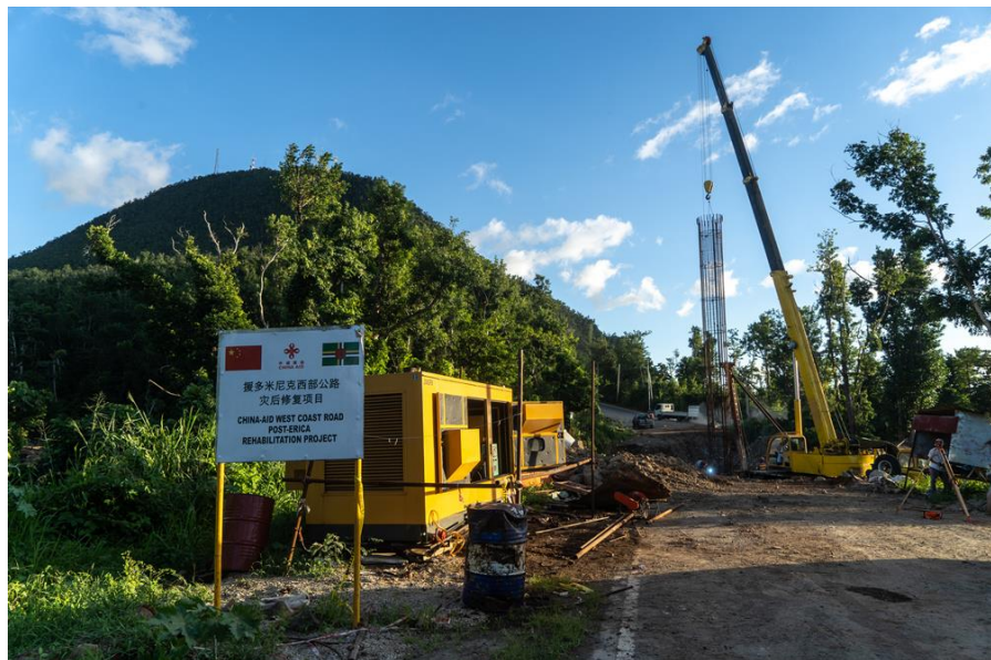
中国政府援建的西部公路热带风暴灾后修复项目正在进行钢筋笼下放作业 (2019年1月)
