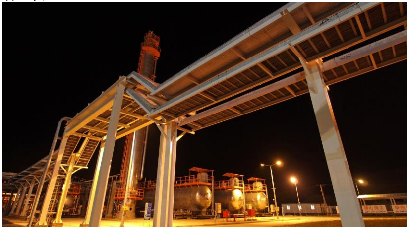
北阿扎德甘油田中心处理站
